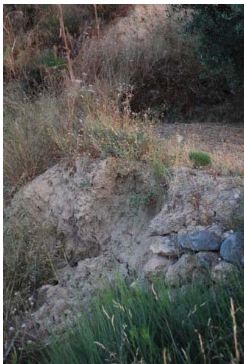
Las margas son un sustrato fácilmente erosionable por el agua.
