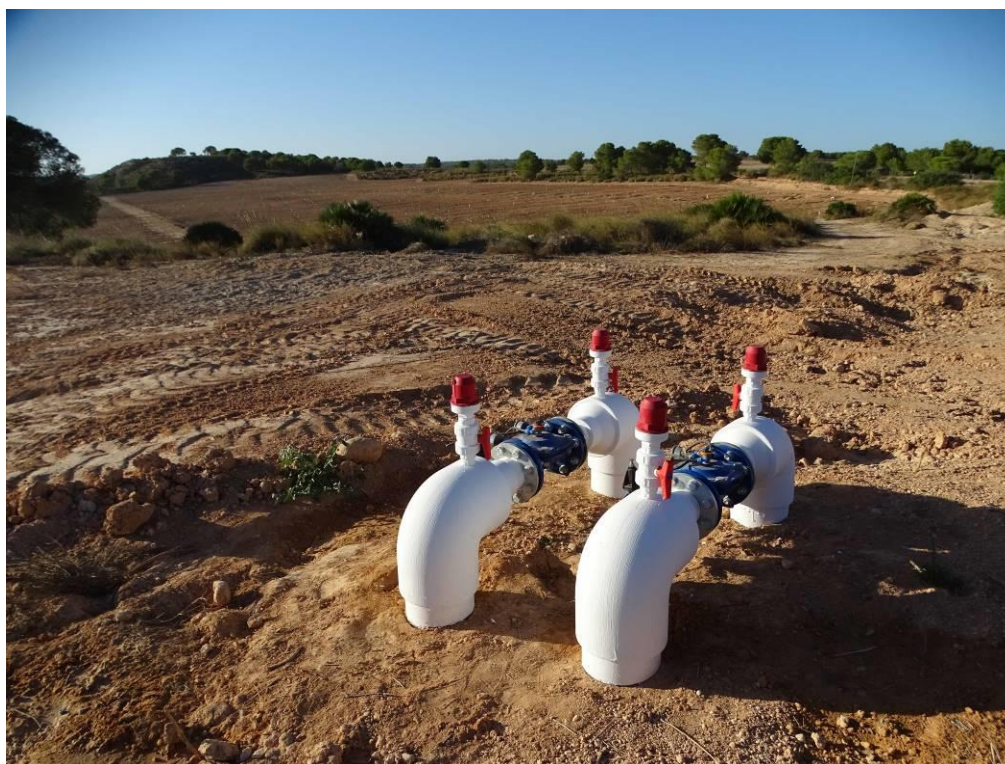
Imagen 17. Detalle del nuevo sistema de riego instalado, junto a la carretera que hace de límite sur de la ZEPA. Al fondo nuevas plantaciones de cítricos. Fuente: P.García/ANSE
