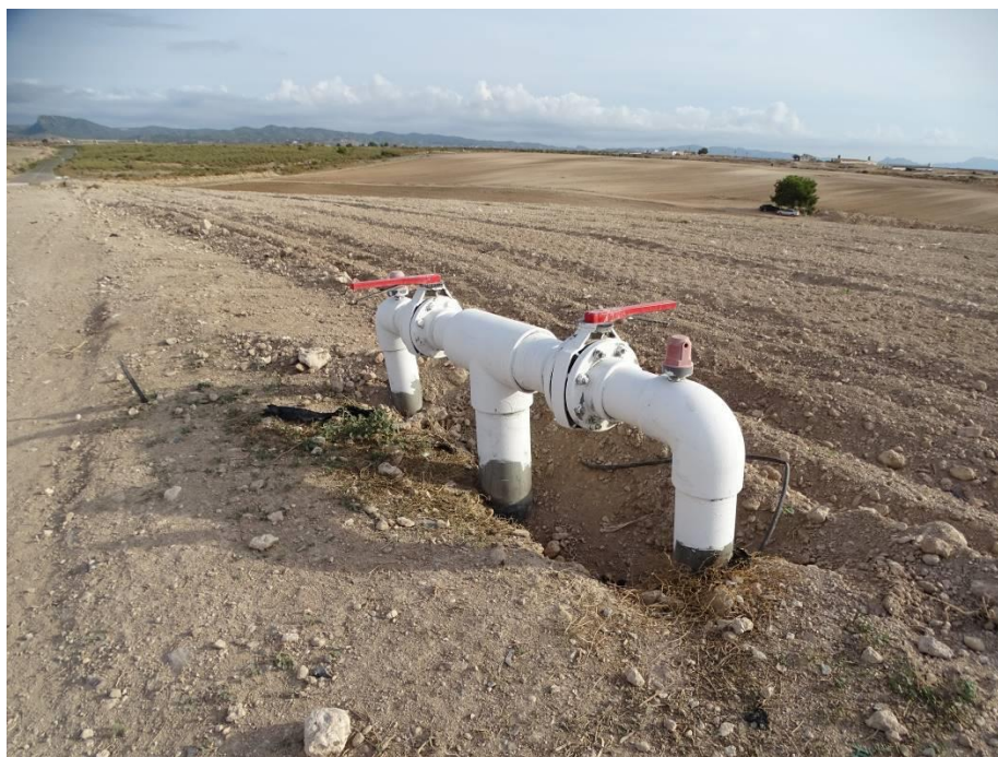
Imagen 8. Tuberías de distribución de agua para el cultivo de hortalizas en las proximidades de la Sierra de Carrascoy, al norte del municipio de Fuente Álamo. Al fondo se observan laderas aún cubiertas de vegetación natural (verano 2017) Fuente: P.García/ANSE
