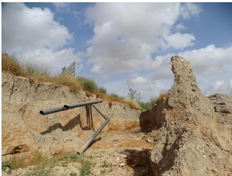
Imagen 23. Ocupación y relleno del cauce de la rambla, aguas arriba del invernadero de la imagen anterior. Fuente: P.García/ANSE
