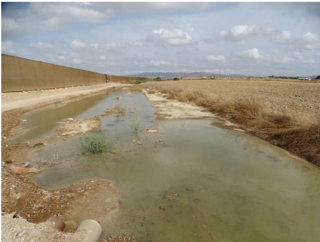
Imagen 24. Aguas de drenaje circulando por lecho de la misma rambla cuyo cauce ha sido modificado y parcialmente ocupado. Fuente: P.García/ANSE
