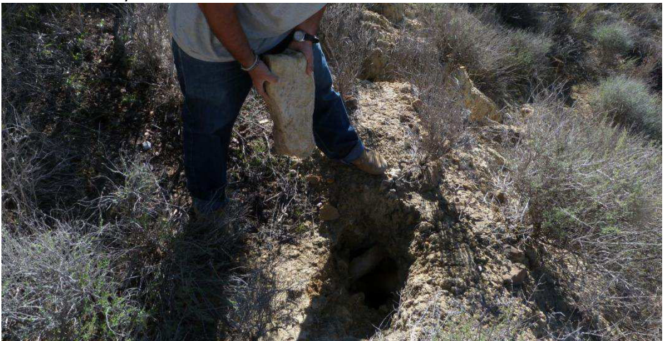
Obstrucción de un pipping en una terraza mediante rocas
