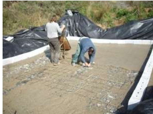
Los voluntarios extendieron la lona impermeable y a continuación se colocó el hormigón /ANSE
